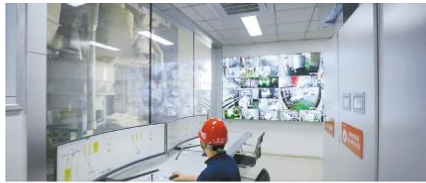
通威农发智能化中央控制室
