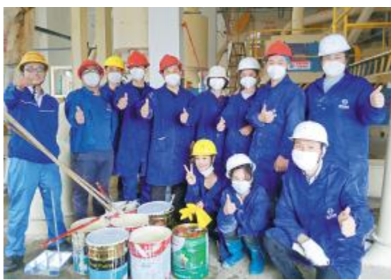
宾阳通威后勤团队齐上阵,积极参与工厂标准化改造工作
